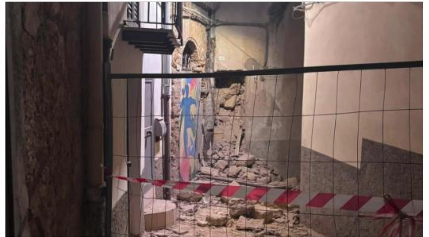
La strada transennata dopo il crollo
